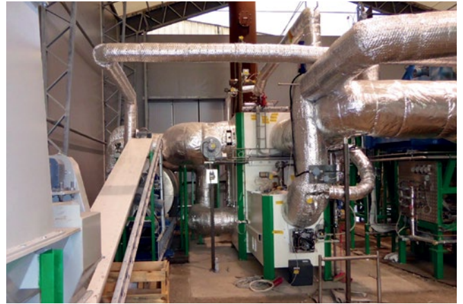
Slutmontage och driftsättning av testanläggningen i Köping om 500 kW syngaseffekt. På bilden ovan syns matningen av biomassa till torken samt hetgasaggregatet.
